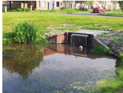
Voorbeeld riool overstort op vijver.
