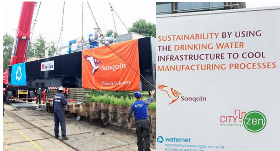
Installatie Sanquin Amsterdam
