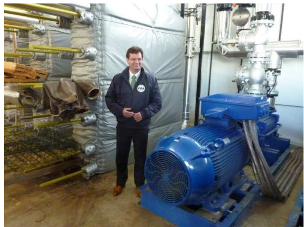
Jaco Geurts voor de warmtewisselaar met links van hem de filters die zouten en ander gruis afscheiden om daarmee verstoppingen in de retour van het afgekoelde water ca 35°C te voorkomen.
